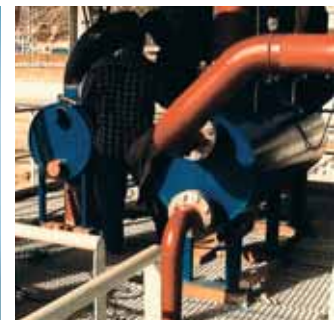
Anlagen zur Ammoniak-Absorption
